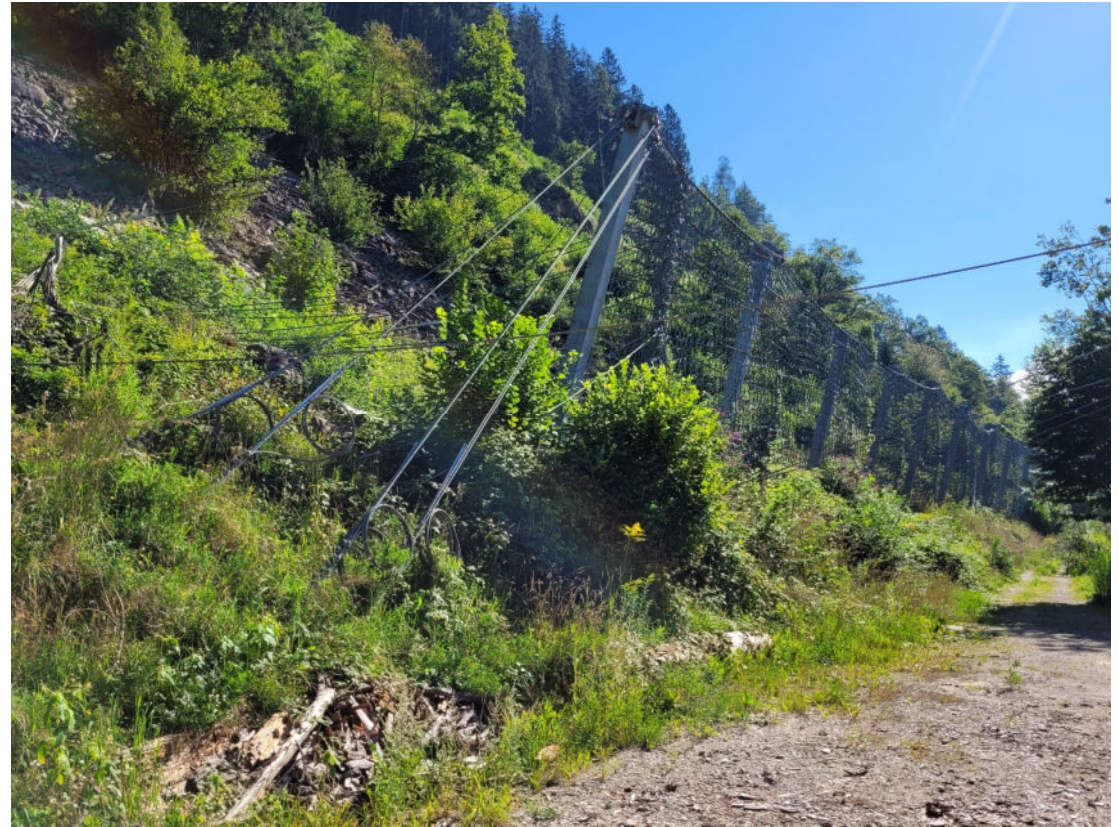
Steinschlagschutzzäun Danielsberg (Österreich) Energieaufnahmevermögen 10.000 kJ, Bauhöhe 7,0 m
