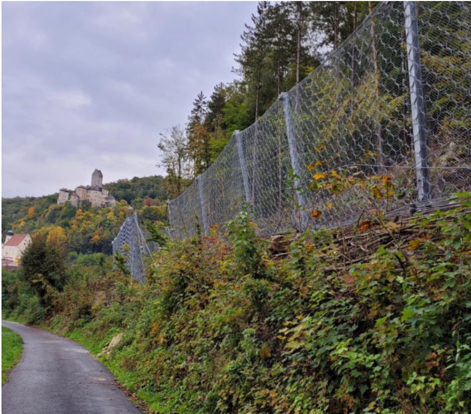
Steinschlagschutzzäun Michaelsberg Kipfenberg, Energieaufnahmevermögen 2.000 kJ, Bauhöhe 6,0 m
